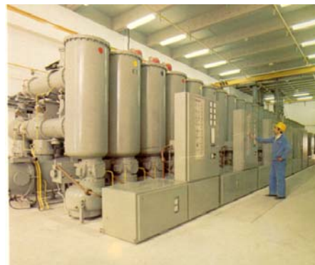
Ζυγοί και διακόπτες 170 kV με μόνωση αερίου SF 6 (GIS)
