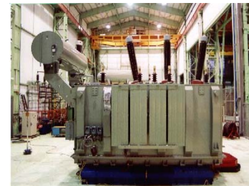
Μετασχηματιστής 150/21 kV, 50 MVA
