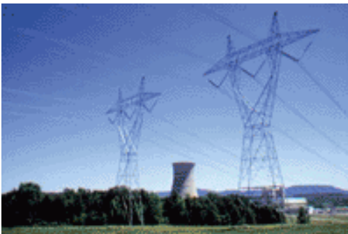
Γραμμή μεταφοράς 400 kV
