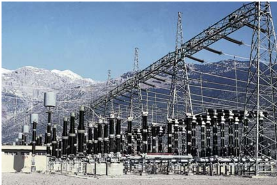
Κέντρο Υπερψηλής Τάσης 400/150 kV
