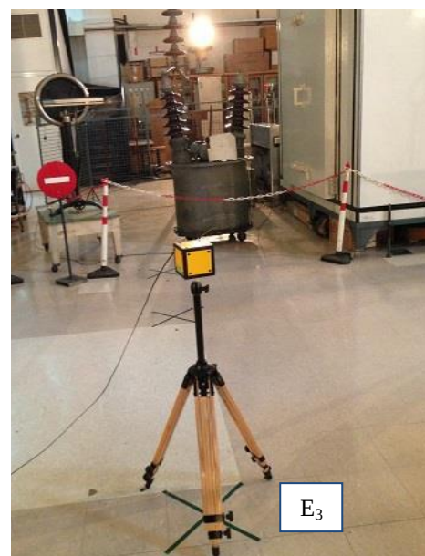
Σχήμα 3: Θέση μέτρησης 3 του ηλεκτρικού πεδίου
